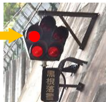
【落石警報機（動作中）】
