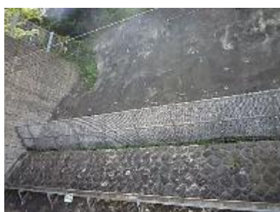
【落石受けフェンス】
