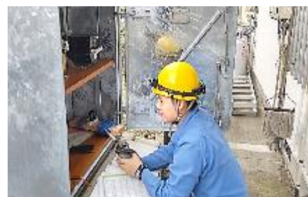
【信号機器の点検】
