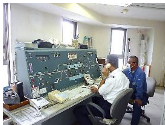
【信号現場取り扱い】
