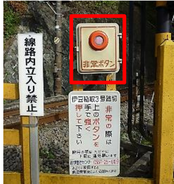
【非常押しボタン】
