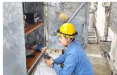
【信号機器の点検】
