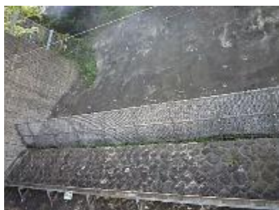
【落石受けフェンス】
