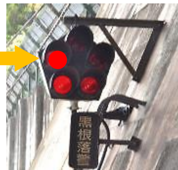
【落石警報機（動作中）】
