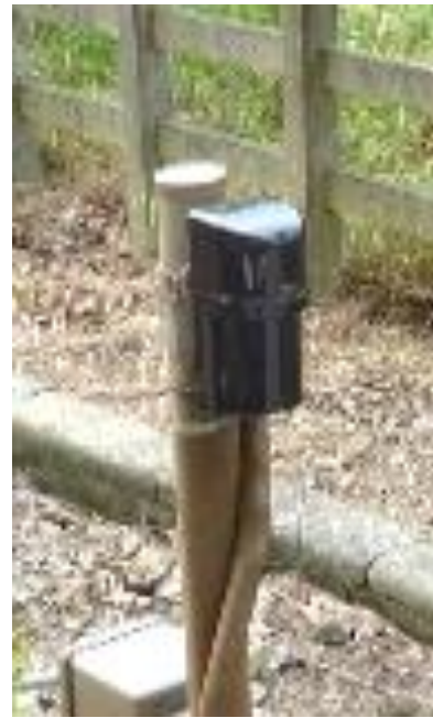
【踏切障害センサー】
