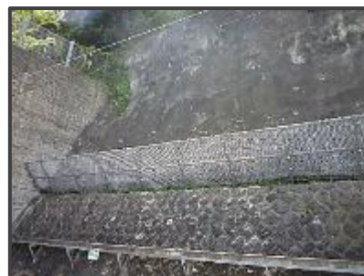
【落石受けフェンス】
