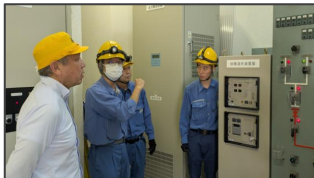
【電気設備法定検査の立ち会い】
