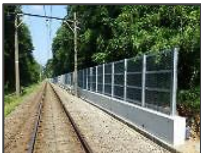
【落石防護フェンス】
