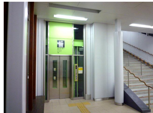
【2番線エレベーター】
