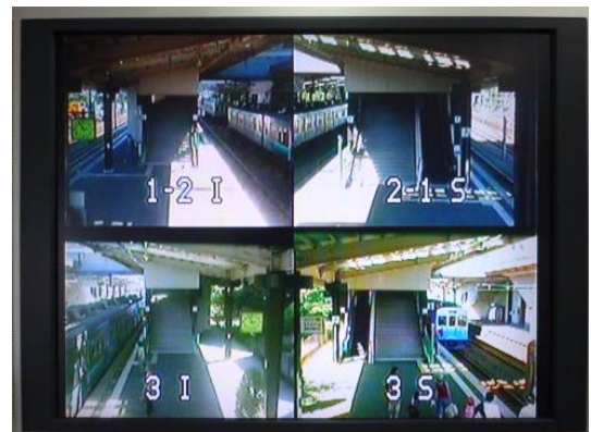
【監視モニター】
