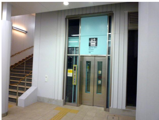
【1番線エレベーター】
