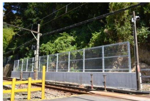
【落石防護フェンス】
