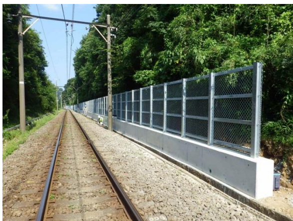
【落石防護フェンス】
