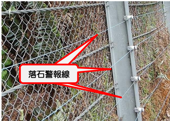
【落石防護フェンスに敷設している落石警報線】
