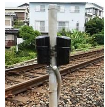
【踏切障害センサー】
