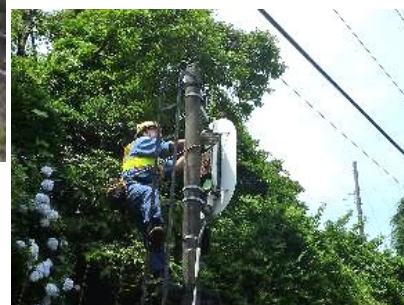
【信号設備の点検】
