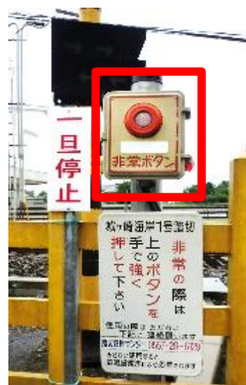
【非常押しボタン】
