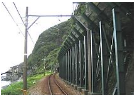
【落石防護フェンス】
