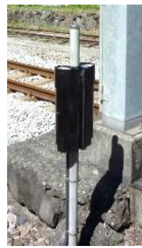
【踏切障害センサー】
