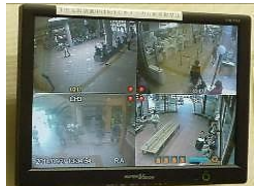
【監視モニター】
