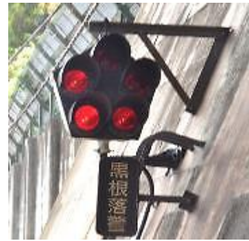
【落石警報機（動作中）】
