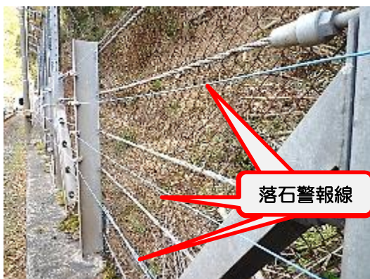
【落石防護フェンスに敷設している落石警報線】
