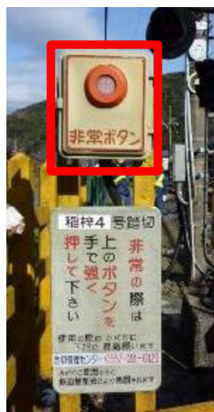
【非常押しボタン】
