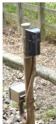
【踏切障害センサー】
