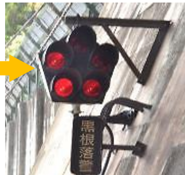
【落石警報機（動作中）】
