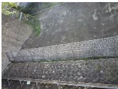
【落石受けフェンス】
