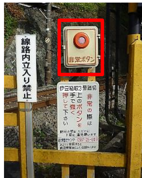
【非常押しボタン】
