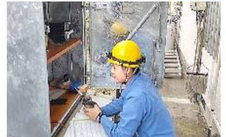
【信号機器の点検】
