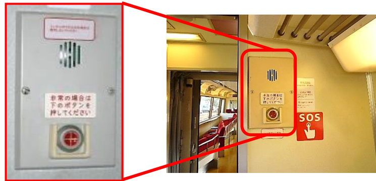
【非常通報装置】
